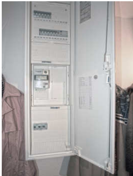
Wohnung Nr. XX, SF (Elektrische Anlage, saniert)
