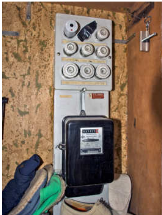
Wohnung Nr. XX, GG (Elektrische Anlage, unsaniert)
